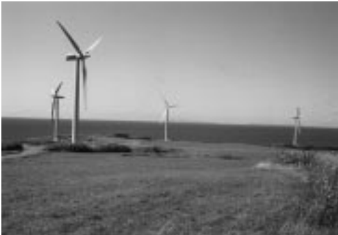
海を見おろす丘に立つ風力発電所(苫前町)
